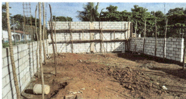
Foto 1: En obsecacion que falta de terminación de la construcción del aula.
