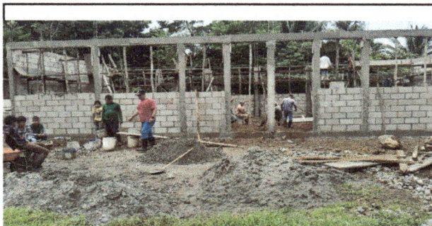
Foto 5: Falta la terminación de mojonetas de sostención de techo.
