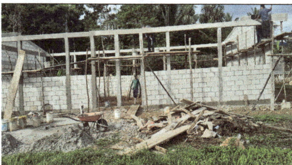
Foto 4: La cubierta de los techos lámina constanera y solera del aula
